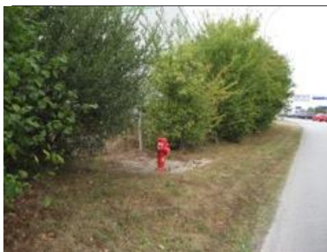
Figure 1 : Borne incendie à l'entrée du site
